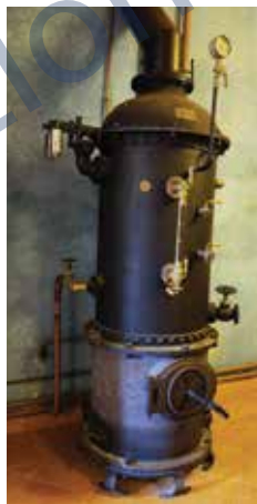
80 | La caldaia in ghisa per l'ebollizione dell'acqua, all'interno del frantoio.
