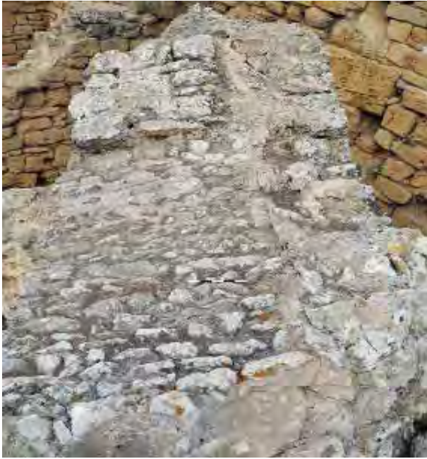
Fig. 4.28. Frammento di volte crollato nella taberna 9: vista dell'intradosso. Sono visibili lo spessore del muro di terrazzamento delle tabernae (a destra), le reni in blocchetti squadrate, la risega di appoggio della centina e l'intradosso formato da pietre irregolari disposte radialmente.
