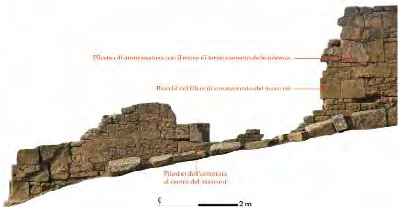
Fig. 2.28. Livello inferiore, dettaglio del prospetto esterno del muro perimetrale della nona taberna , vista da est (ortofotopiano da nuvola di punti 3D).
