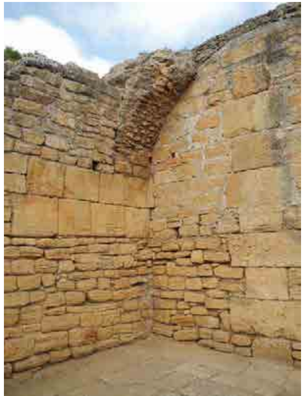
Fig. 2.17. Livello inferiore, prima taberna , vista dell'angolo interno nordovest; si osservano i due filari di coronamento del muro ovest, sui quali si imposta la porzione conservata della volta a botte.
