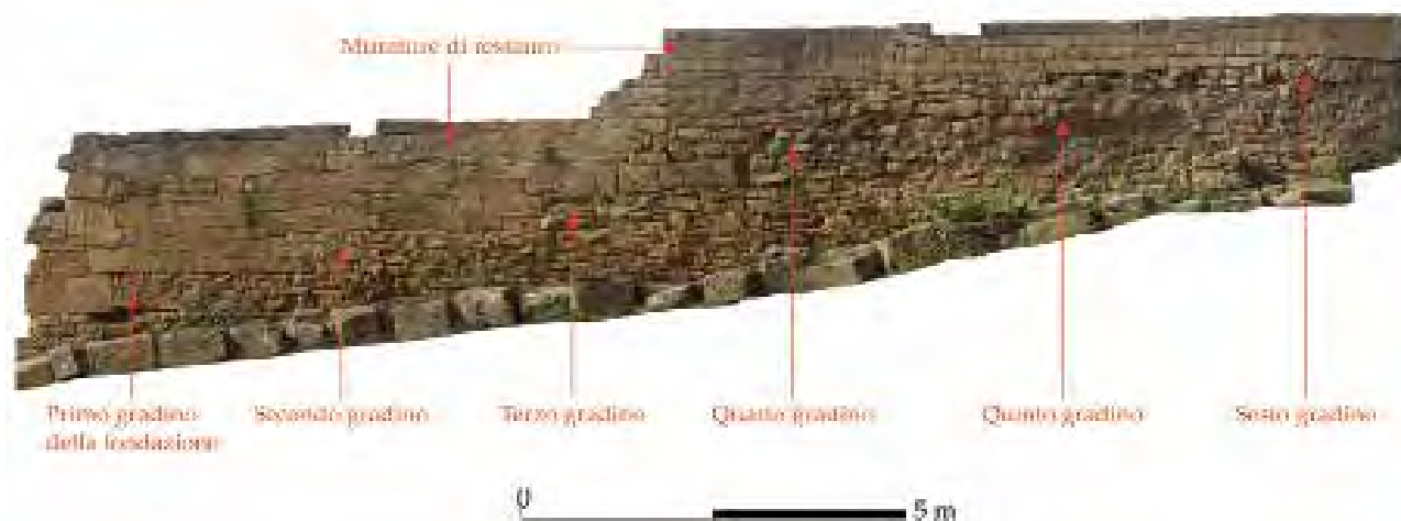
Fig. 2.38. Livello superiore, dettaglio del prospetto esterno del peribolo est (ortofotopiano da nuvola di punti 3D).
