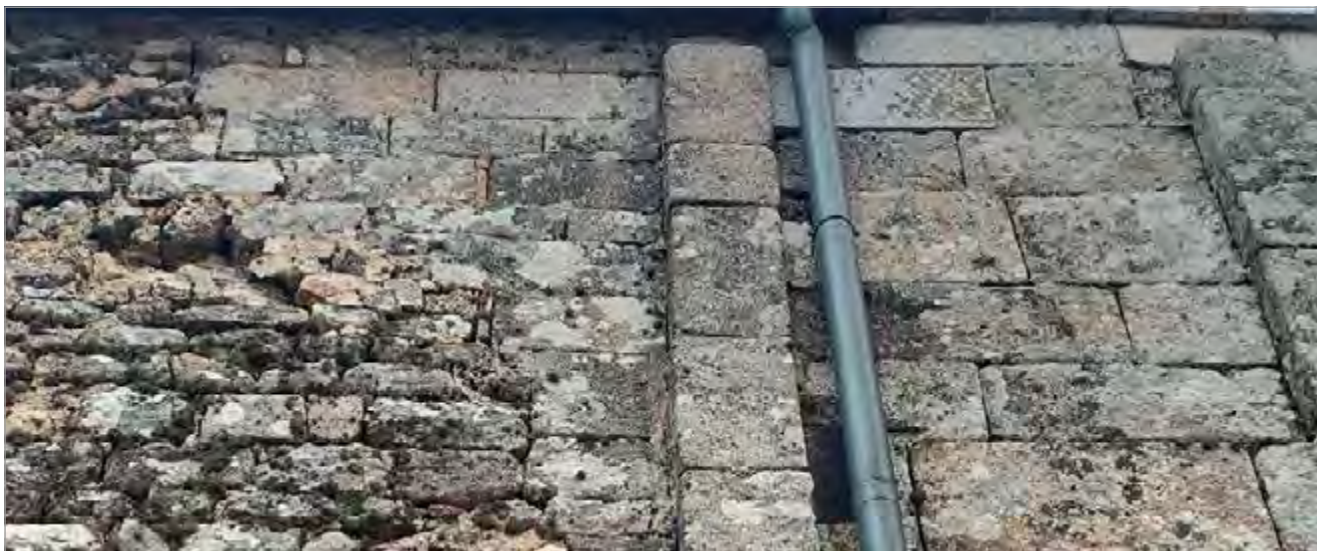
fig. 193 – Isola d’Elba, chiesa di S. Pietro. Particolare della porzione superiore del fianco sinistro nel punto in cui la muratura legata alla lesena di XII secolo si appoggia alla muratura sottostante.
