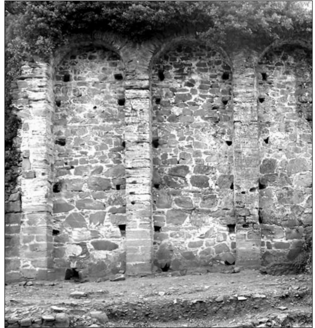
Fig. 4 - Acropoli: il terrazzamento ad arcate dell'edificio delle Logge e, in primo piano, il muro di sostruzione del terrazzo inferiore.
