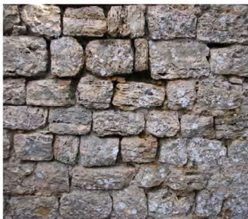
Tecnica 2. Torre crollata. Campione non in scala
