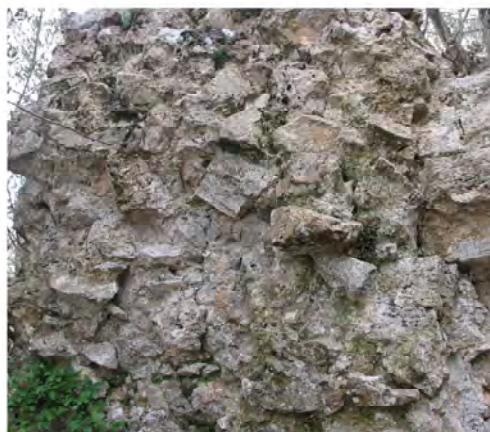
Tecnica 2. Torre crollata. Riempimento
